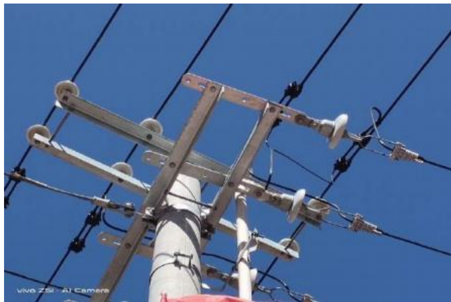
低压线路T接
