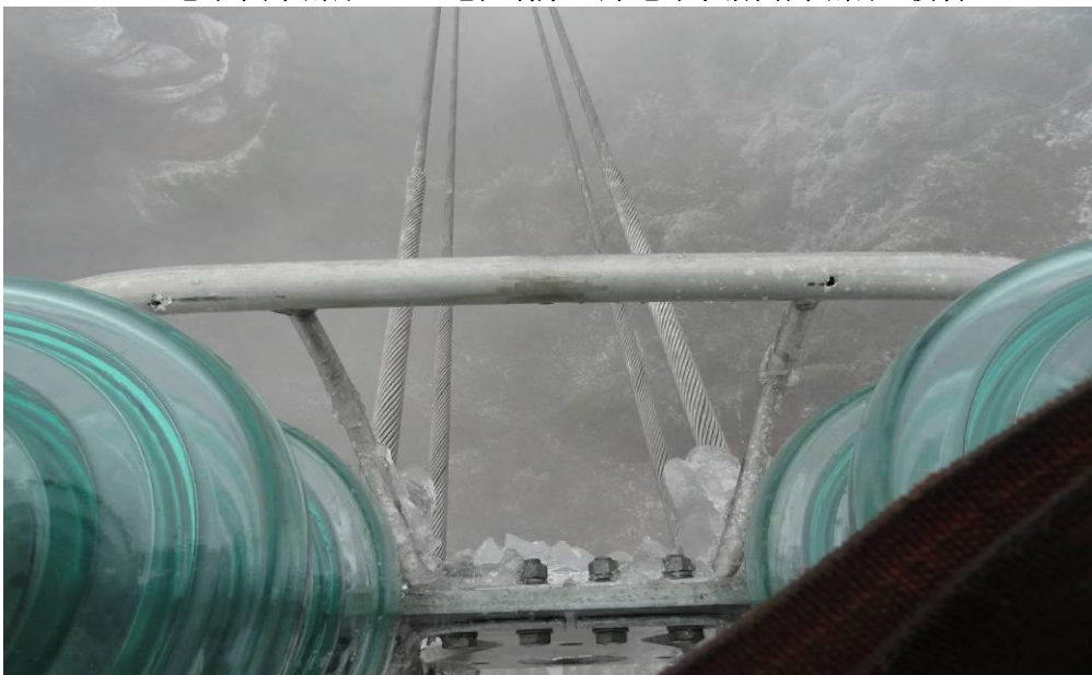
图 X 均压环闪络痕迹（高压端均压环被击穿）（样图）
