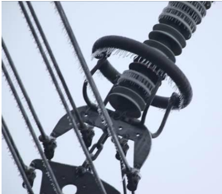
图 X 视频监测装置拍摄到线路覆冰情况
