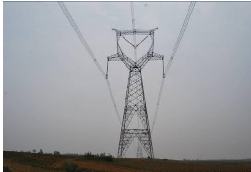
图 X 故障杆塔整体图(需标注相别(极性))(样图)
