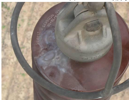
(a) ***极 I 低压侧绝缘子表面电弧灼烧痕迹
