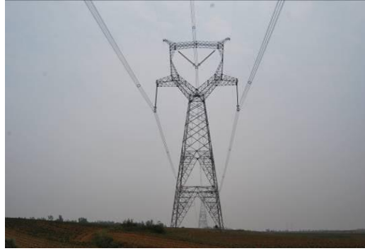
图 X 故障杆塔整体图（需标注相别（极性））（样图）
