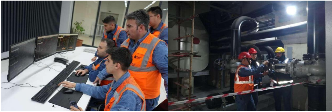
图 4 震后电厂运行调整和氢冷器隔离操作
