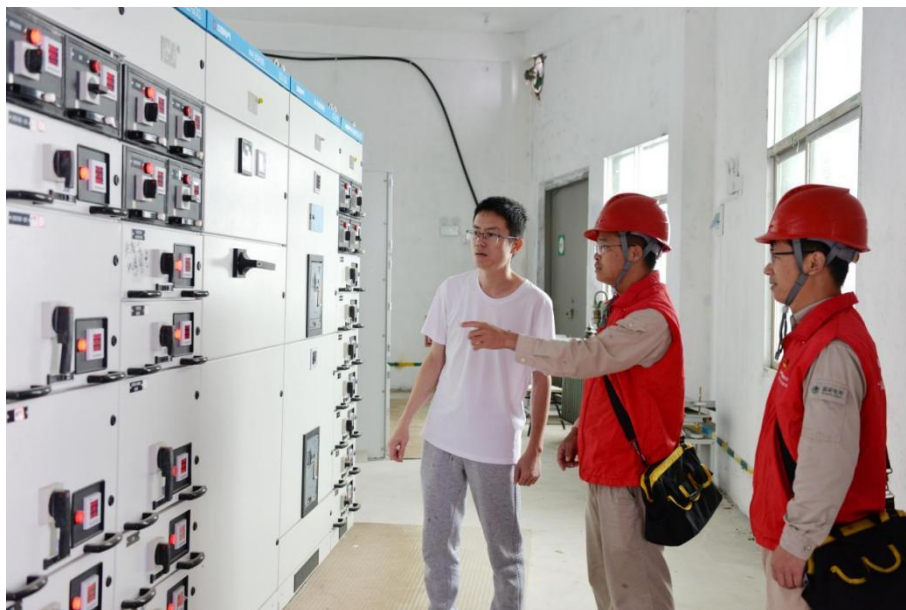
图 3 重要用户用电安全排查
