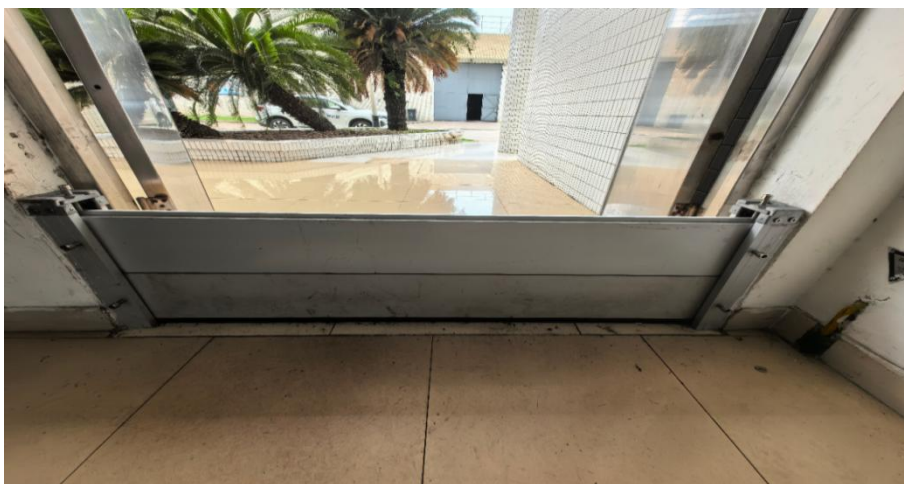
图 12 可拆卸防洪挡板
