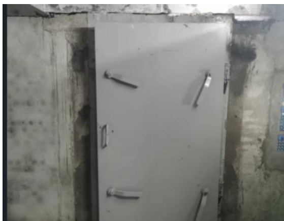
图 7 出线洞内加强型防洪门
