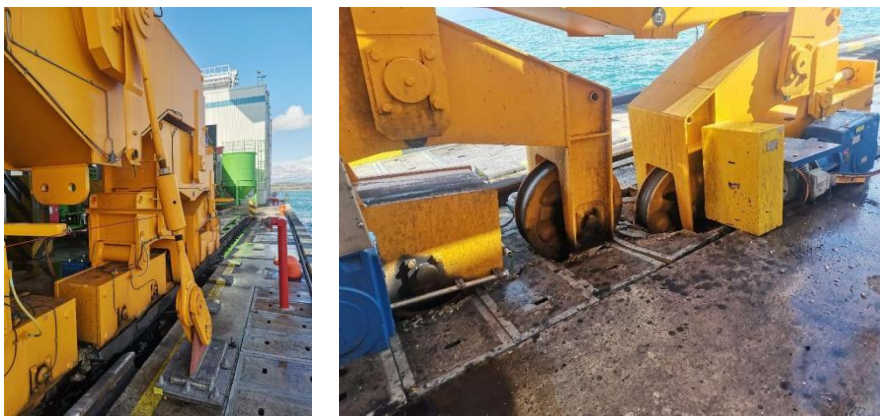
图3 土耳其7.8级地震震后电厂受损情况
