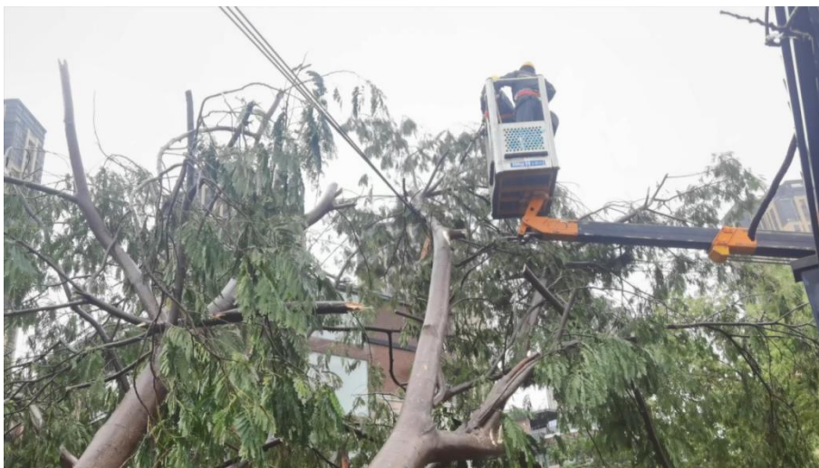
图 2 线路走廊超高树木清障
