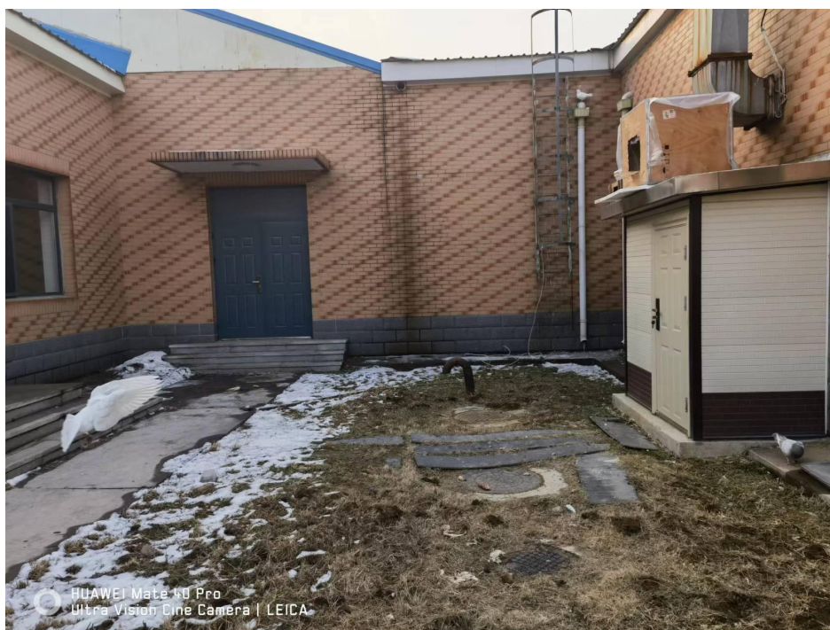
图 9-1 沈东 500 千伏变电站内生活污水处理装置
