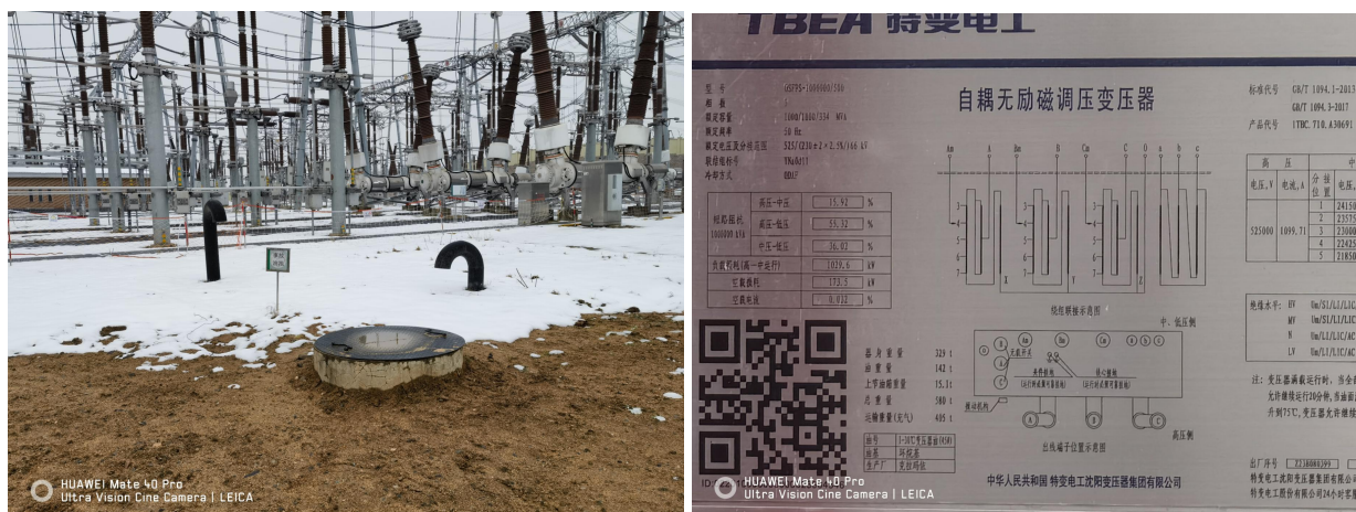
图11-1事故油池及变压器铭牌
