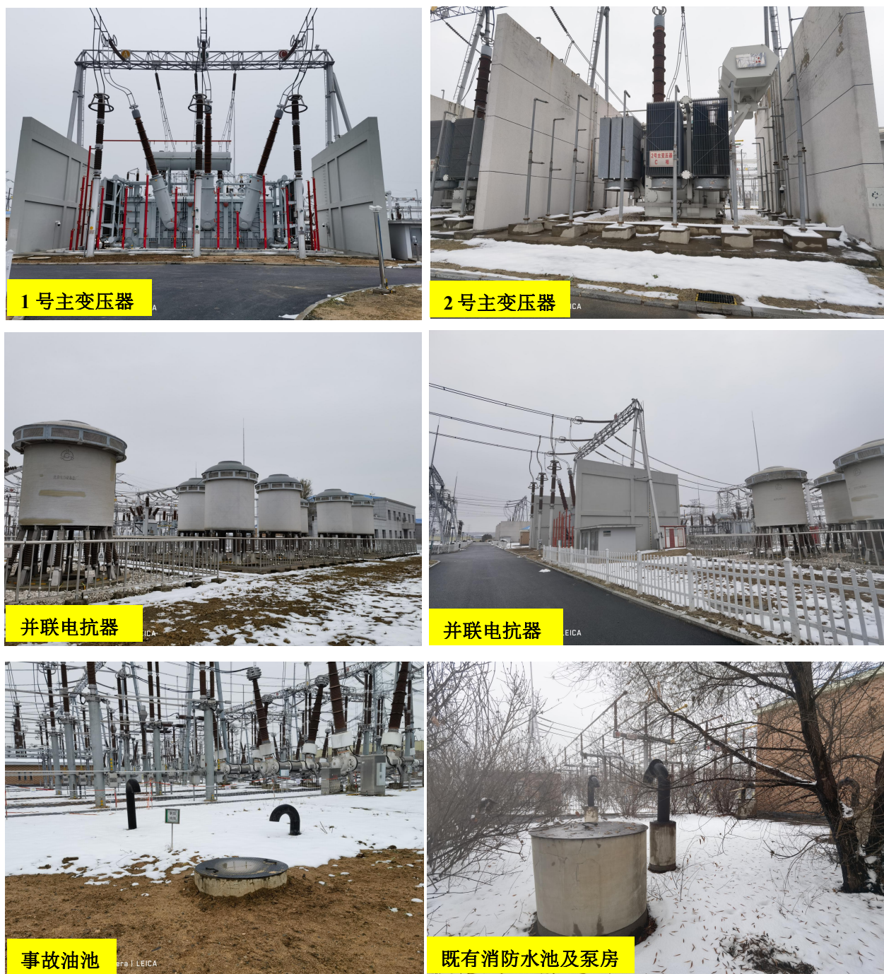
图 3-2 沈东变电站内设备、设施
