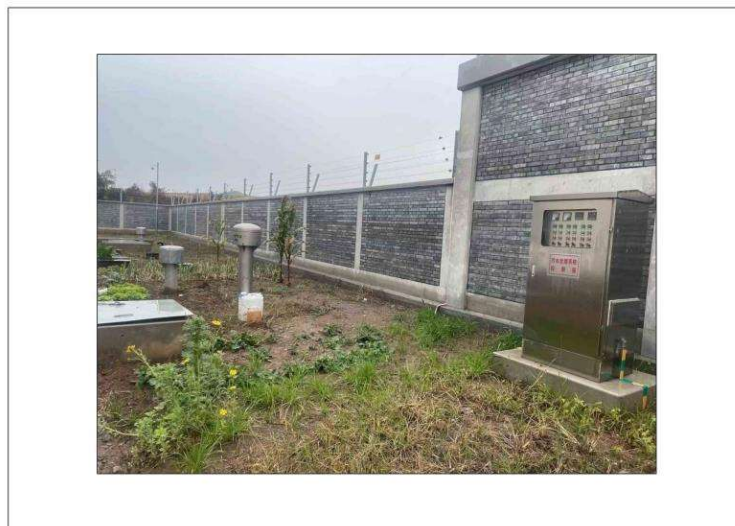
图9.1 析木500kV变电站污水处理装置照片
