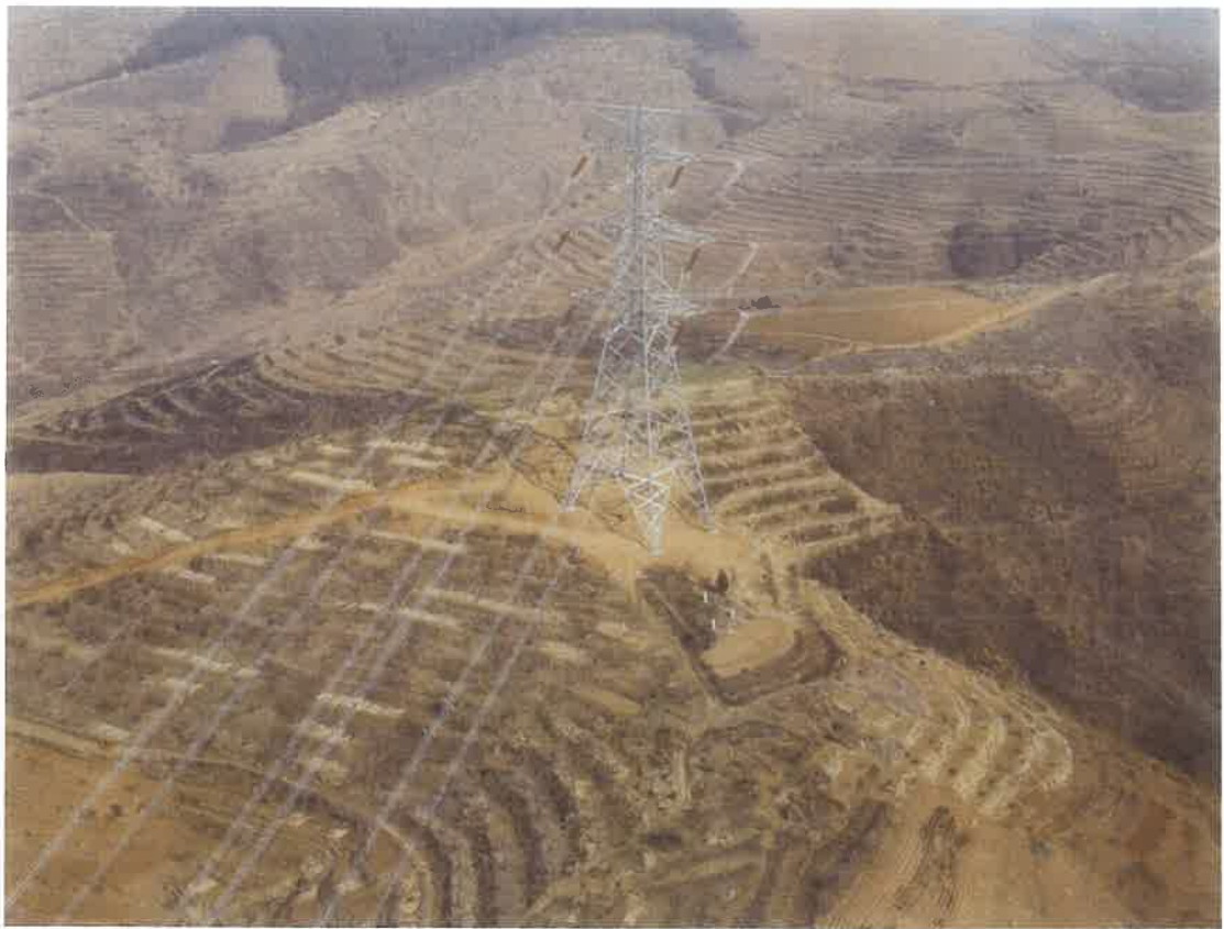
北侧出线 3 号塔
