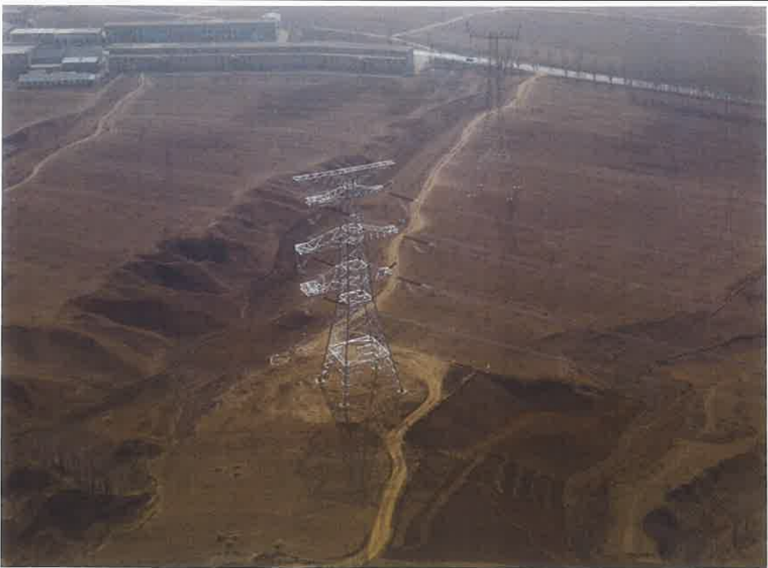
南侧出线 \pi 接 3 号塔
