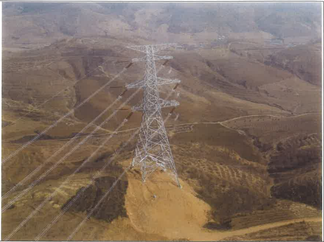
北侧出线 \pi 接塔 4 号
